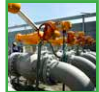
Instalaciones de gas
