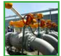
Instalaciones de gas
