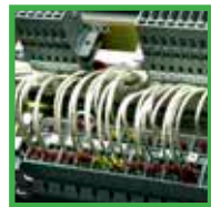
Armarios eléctricos y subestaciones
