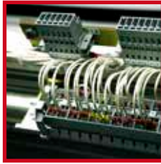
Armarios eléctricos y subestaciones
