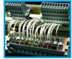
ARMARIOS ELÉCTRICOS Y SUBESTACIONES
